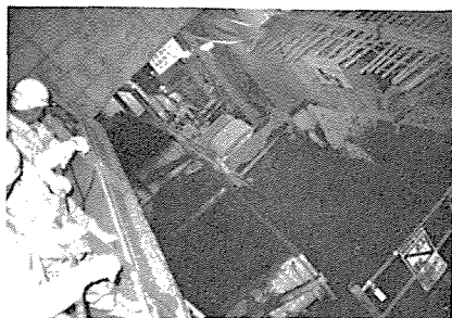
写真-4 サージビンロータリフィーダ稼動中
