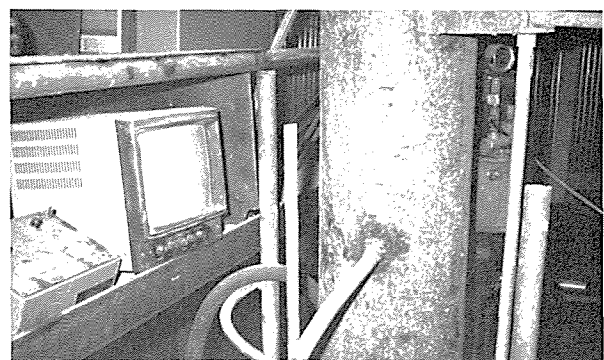
写真-3 土砂ホッパ吹出口モニターテレビ
