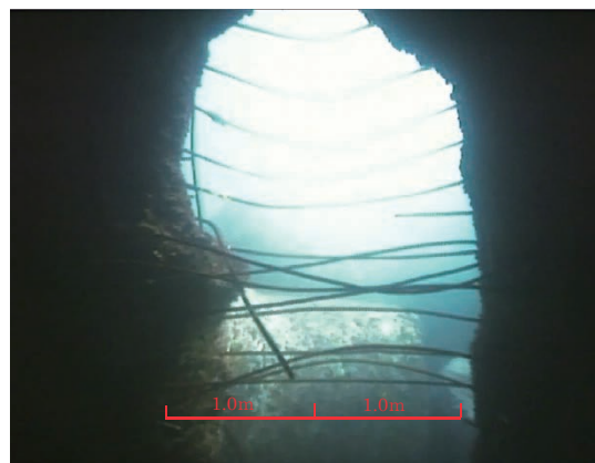
写真―8 ケーソン側壁破損状況
