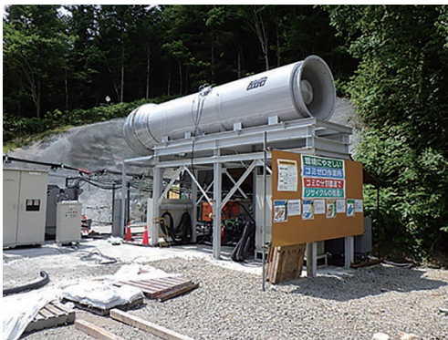
写真-1 換気ファン
