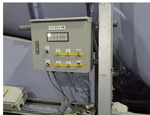
写真-4 制御システム子機（集じん機）
