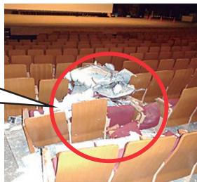
写真-1 天井・座席被災状況
