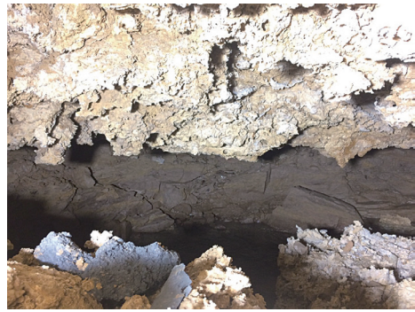
写真－1 空洞発生状況
