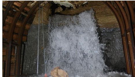
写真－2 大量出水状況（大雨後）
