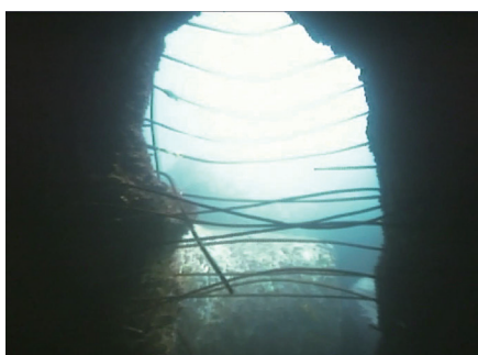
写真-2 ケーソン側壁破損状況
