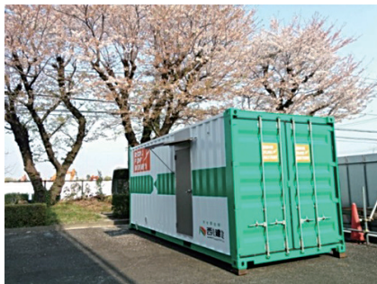
写真-1 RF 電池試験機収納コンテナ外観図
