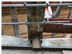
写真一9 落下防止対策
