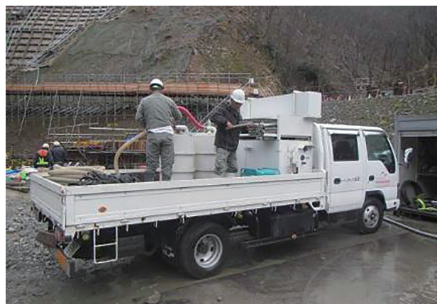
写真－8 真空ポンプ搭載車両
