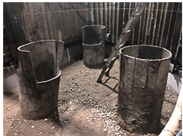
写真-1 支障杭（鋼管杭）
