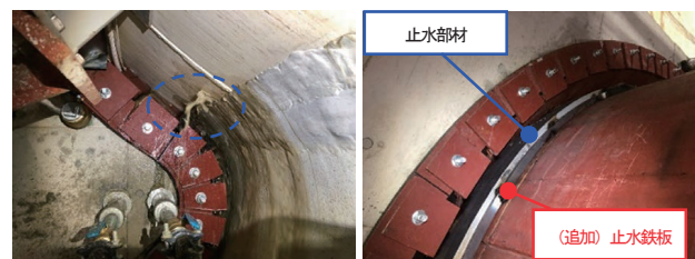
写真—7 縁切れによる泥水漏出
