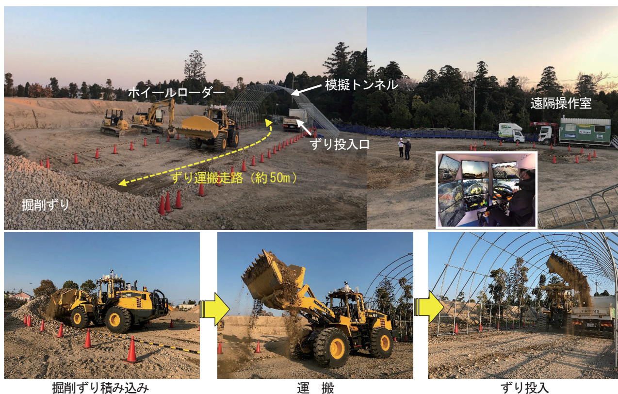
写真-7 屋外ヤードにおける遠隔操作試験状況
