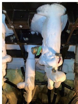
(b) 結露した凍結管
