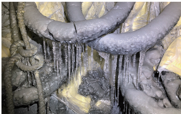
写真一1 凍結環境下で生じたつらら
