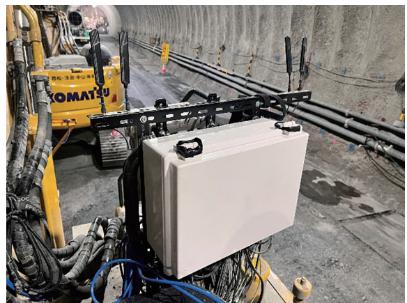
写真一3 映像・制御信号伝送システム
