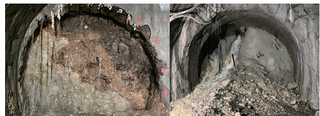
写真一1 崩落前の切羽状況と突発湧水・切羽崩落状況
