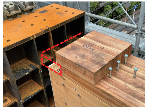
写真ー4 嵩上げ材の欠き込み状況
