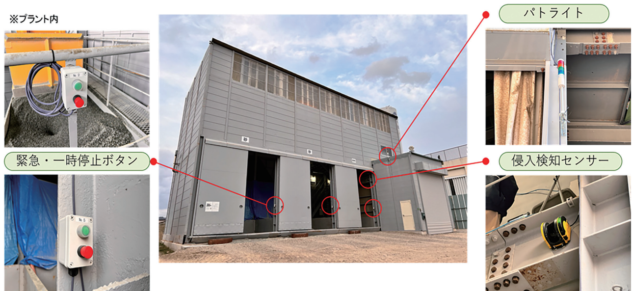
図ー5 パッチャープラント内安全対策
