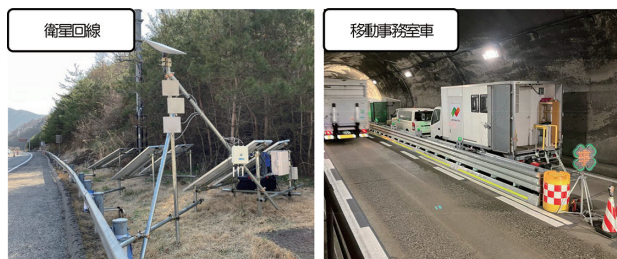
写真-3 衛星回線、移動事務室車
