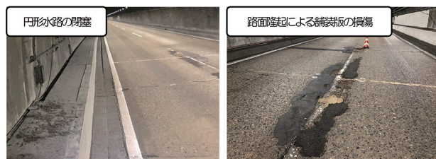
写真-1 変状状況
