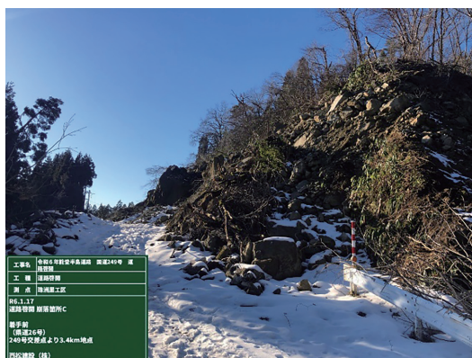
写真一1 県道26号 被災状況
