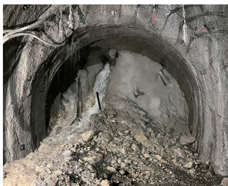
写真一 突発湧水・切羽崩落状況
