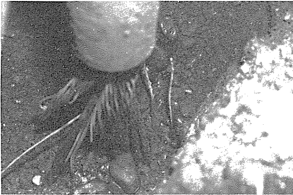
Photo-7 ケーブル No.1 破断状況 Cutting of No.1 cable
